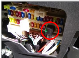
3.10 接正极线：将保险丝取电器插入保险盒内；注意：如图对对应位置正极插入，若反插将导致尾门无法使用
